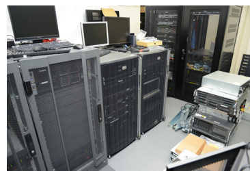
八潮事業所 サーバルーム
